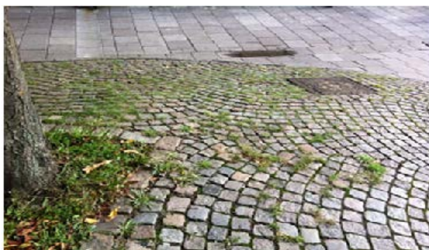
Bild 6 Gatstenar skapar svårigheter vid underhåll.
