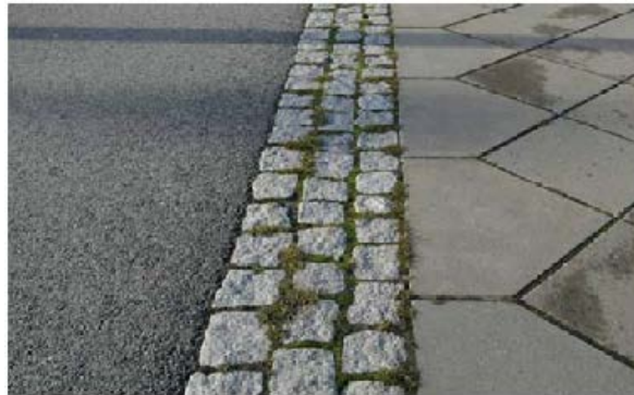
Bild 8 illustrerar svårigheterna med underhållet (Trafikverket 2011).
