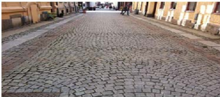
Bild 5 illustrerar sättningar orsakade av tunga laster.
